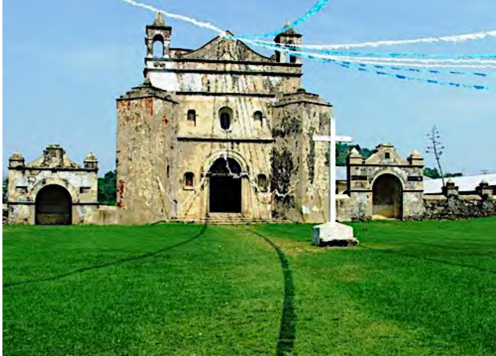
62. Templo de San Miguel Arcángel de Tumbalá, Chiapas. Nótese las capillas posas, la cruz atrial y el atrio amurallado. Foto: JFGC.
