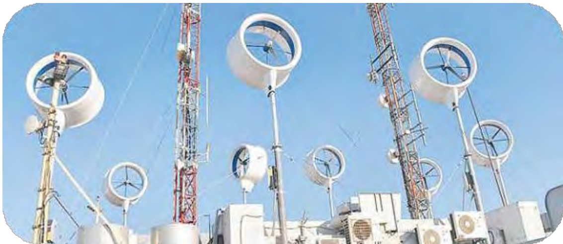
Capítulo 3 Imagen 14 DonQi instalado sobre techo
