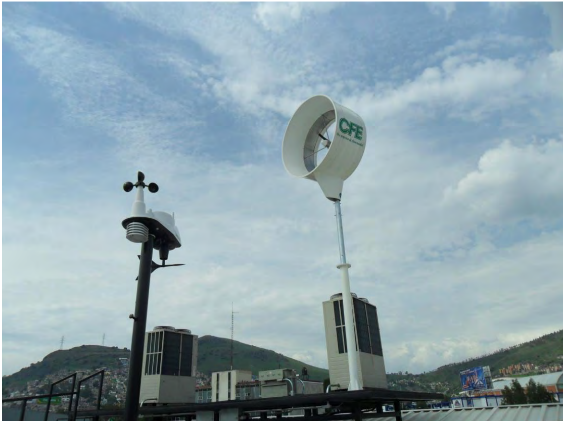
Capítulo 4 Imagen 6 Aerogenerador y estación meteorológica
