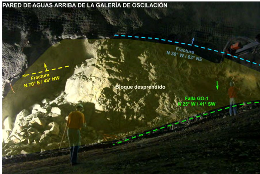
Figura 2.107.- Bloque desprendido en la pared de aguas arriba de la GO.
