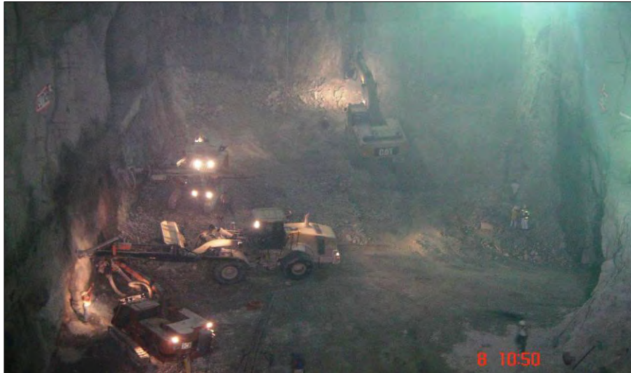
Figura 2.52.- Equipo utilizado en el proceso de excavación de banqueros y fosos de turbina.
