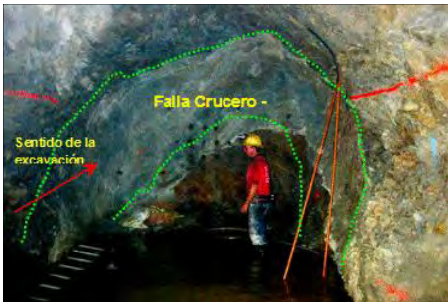
Figura 2.14.- Aspecto de la falla Crucero-Pitayo en el cadenamamiento 0+024,0 m del crucero 0+290,6 izquierdo del socavón 04 MD.
