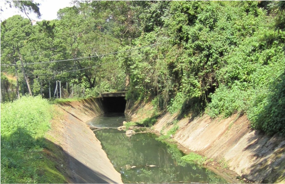
Imagen 14.- C.H. Zumpimito, Michoacán. Canal de conducción trapezoidal revestido
