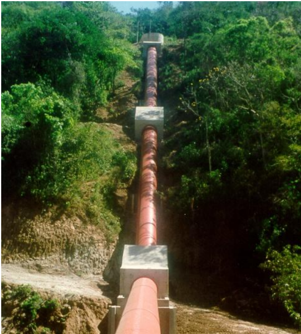
Imagen 17.- Tubería a presión libre al exterior
