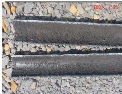
Figura 15. Efectos del H 2 S y del CO 2 en las tuberías.
