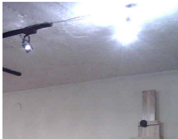
DISPOSICIÓN DE LUCES TIPO “SPOT” SOBRE RIELES EN TOPOLOGÍA DE CUADRANTES (ILUMINACIÓN BASE)
