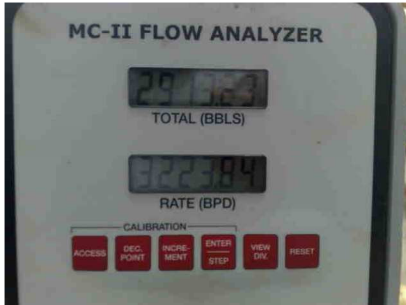
Figura 3.33. Parámetros de Operación de la Bomba Quintuplex Superficial, Pozo Secadero 1001.
