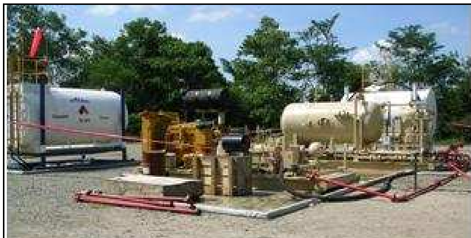
Figura 3.20. Instalación Superficial con el Separador de Alta Presión en el Pozo Secadero 1. 50
