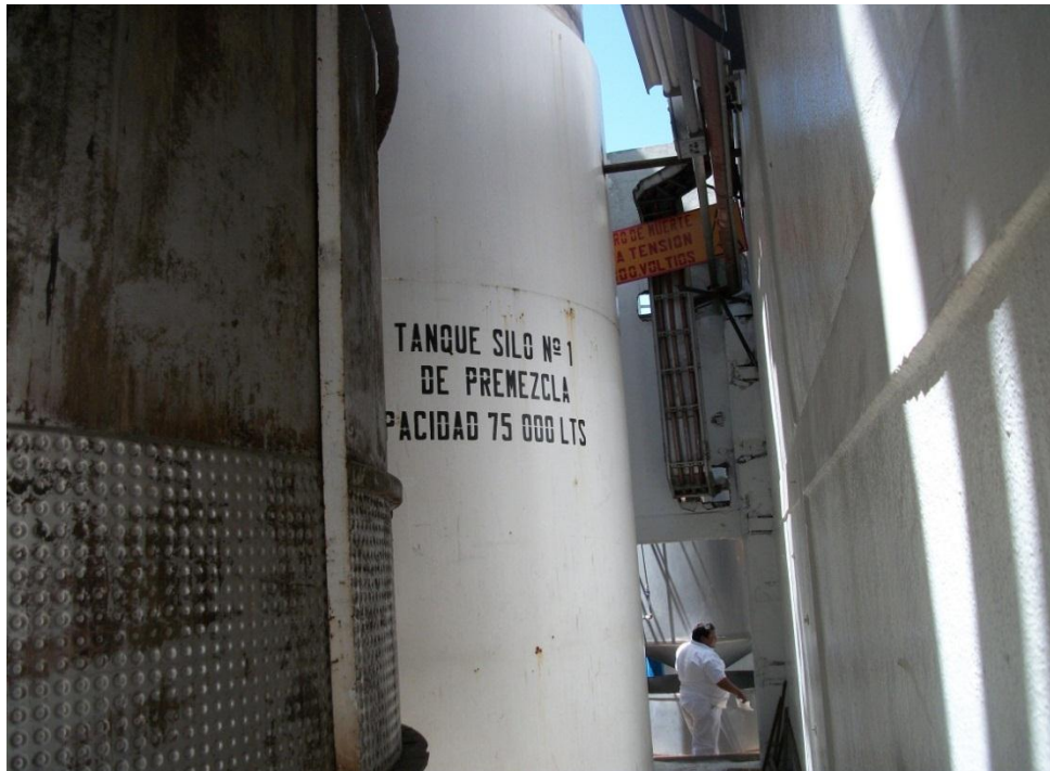
Figura 4.- Silos de pre-mezcla, planta Licónsa Norte. Fotografía tomada con permiso de la administración. (17 septiembre 2012)
