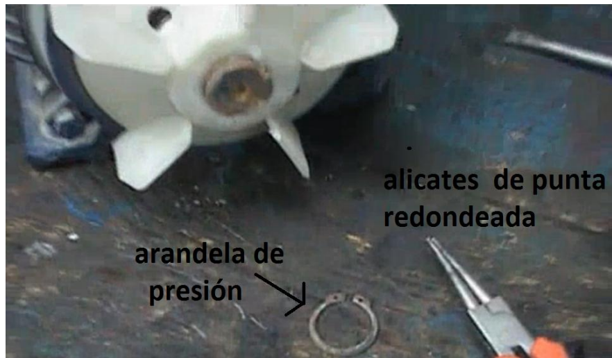
Figura.- 52 Extracción de la arandela de presión del ventilador, planta Liconsa Norte. Fotografía tomada con permiso de la administración (22 septiembre 2012)
