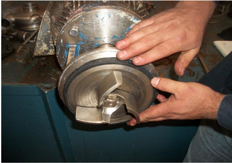
Figura.- 46 Inspección visual al impulsor, planta Liconsa Norte. Fotografía tomada con permiso de la administración (22 septiembre 2012)
