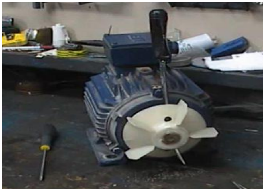
Figura.- 53 Extracción del capuchón y ventilador, planta Liconsa Norte. Fotografía tomada con permiso de la administración (22 septiembre 2012)
