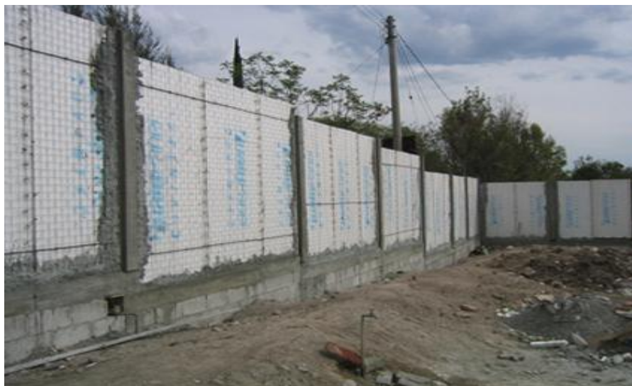
Figura No. 21. Procedimiento constructivo de obra negra para un muro acometida de gran extensión.
