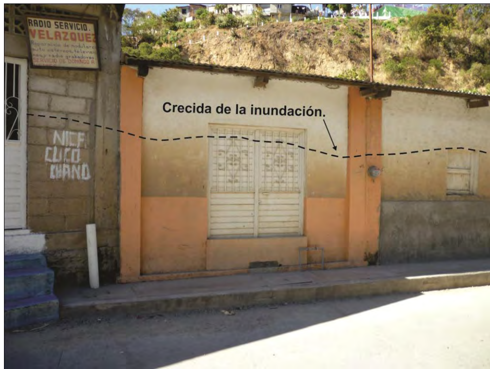
Figura 2.6. Evidencia del aumento del nivel del agua en el río La Mina provocado por el huracán Stan .
