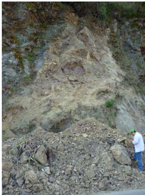
Figura 4.18. Caída de rocas a la orilla de la carretera Motozintla-Las Cruces.
