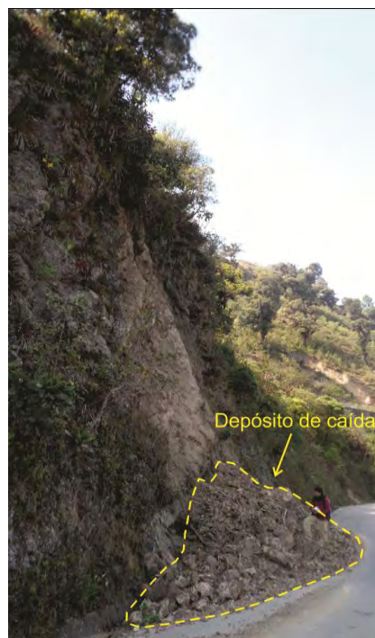
Figura 4.1. Caída de rocas en la margen de la carretera Motozintla-El Pizarrín.
