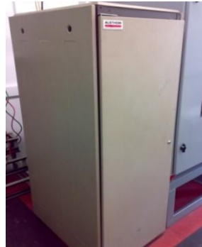
Figura. 2-30 TE-14 manda las alarmas presentes de la subestación a PDC.
