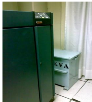
Figura. 2-34 UPS 2000 provee alimentación estática ininterrumpida.
