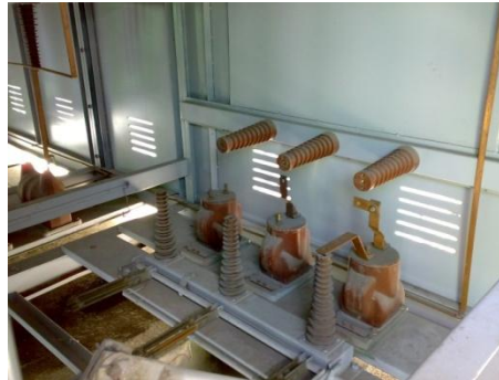
Figura. 3-3 Transformadores de Corriente.
