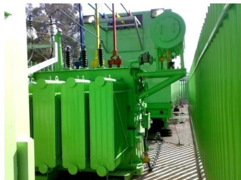
Figura. 4-4 Subestación Dr. Pascua, vista desde dentro.
