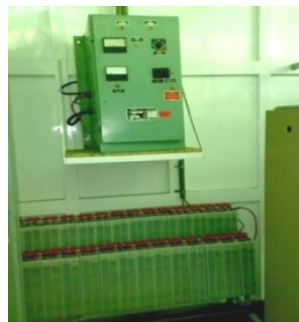
Figura. 2-28 Banco de Baterías de Nickel-Cadmio de 100 Amp/hora, 120 Vcd y Cargador de Baterías con alimentación de 127 Vca, entrega 120 Vcd con 40 Amp. Suministra la corriente necesaria para mantener la carga del Banco de Baterías (flotación).
