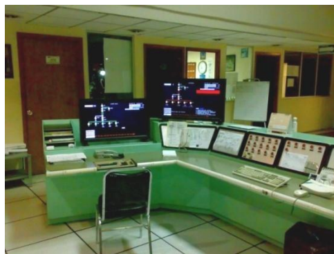
Figura. 2-32 PDC desde aquí se controlan a distancia los equipos principales de las Subestaciones.
