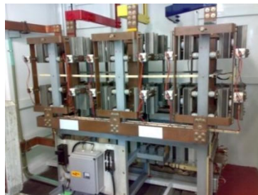
Figura. 2-24 Banco Rectificador de 2500 kVA, 600 Vcd, 2000 Amp. RMS, y 2200 V de pico inverso.
