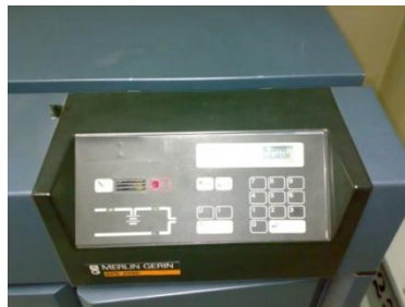
Figura. 2-35 Pantalla del UPS. Red 1 (alimentación normal) y Red 2 (vía de socorro).
