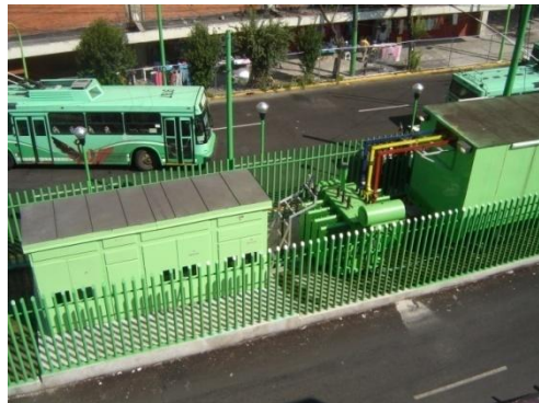
Figura. 4-3 Subestación Dr. Pascua, vista desde arriba.
