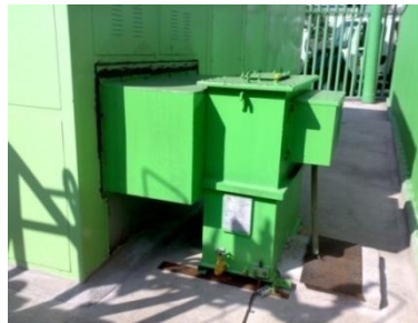
Figura. 2-22 Transformador de Servicio Trifásico de 23 kVca a 220/127 Vca, 30 kVA y a una frecuencia de 60 Hz.
