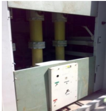
Figura. 2-21 Interruptor en SF6 (52) a 23 kVca. De 1200 Amp. y 500 MVA de Capacidad Interruptiva.
