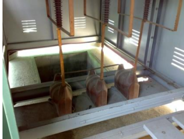
Figura. 2-19 Celda para alojar el equipo de Medición de CFE.
