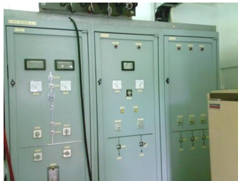
Figura. 2-29 Gabinete de Control, se divide en tres secciones (TG, TD1 y TD2).
