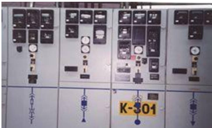
Figura. 3-6 Tablero de control con relevadores de protección.
