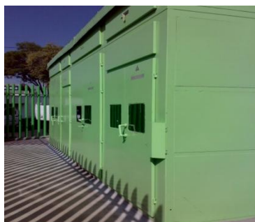
Figura. 2-18 Gabinete de Alta Tensión dividido en cuatro celdas.
