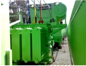
Figura. 2-23 Transformador de Potencia Trifásico de 23 kVca/474 Vca, 2225 kVA y a una frecuencia de 60 Hz.
