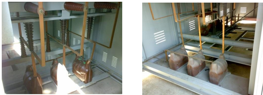
Figura. 3-4 Transformadores de Potencial.
