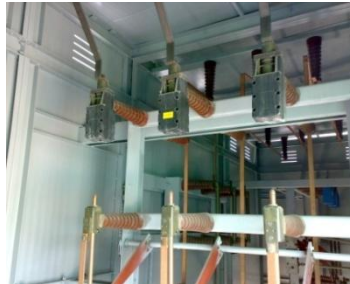
Figura. 2-20 Cuchillas Seccionadoras Trifásicas Generales de 23 kVca. De 400 Amp. de Operación sin Carga.
