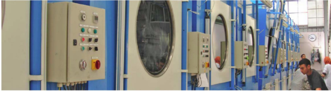
S-250 drying system line, heating with GAS / Línea de secadoras S-250 con calentamiento a gas.
