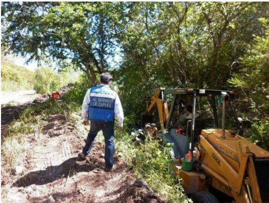
Fotografía No. 66 Se observa retroexcavadora realizando la limpieza del canal de salida de una obra de drenaje.
