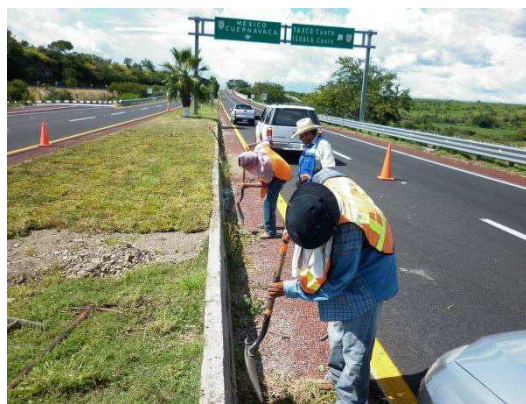
Fotografía No.38. Se observa a personal de la empresa contratista realizando el deshierbe y limpieza de guarnición en el camellón central.
