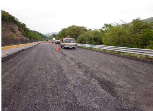
Fotografía No. 113 Vista una vez finalizados los trabajos de renivelación asfáltica con mezcla en caliente.
