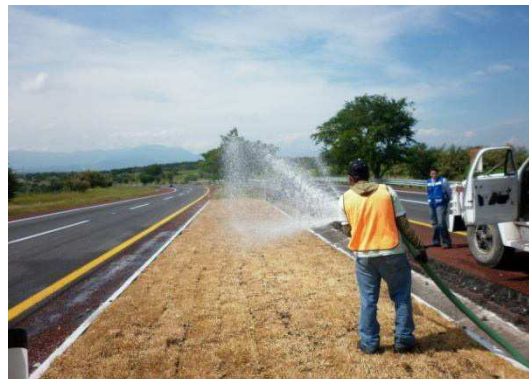
Fotografía No.50. Se observa a personal de la contratista realizando el riego de zonas jardinadas.
