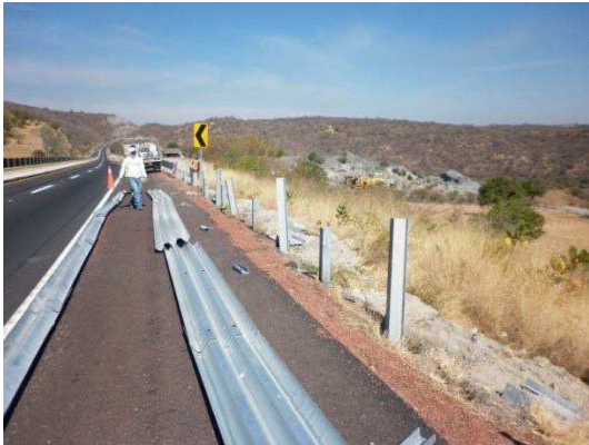
Fotografía No. 92 Se observa tramo antes de iniciar los trabajos de suministro y colocación de defensa metálica de tres crestas.
