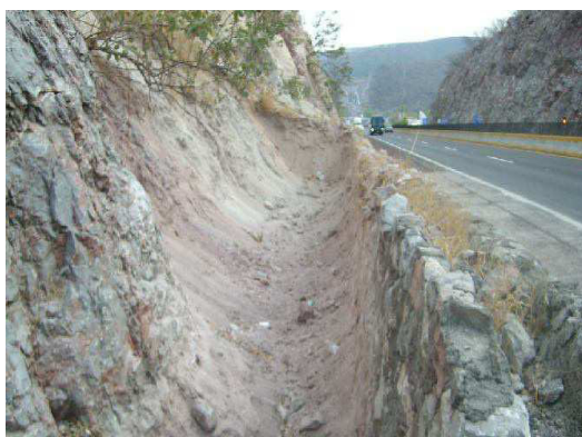
Fotografía No. 76 Vista del muro alcanzó una vez removido el material acumulado.
