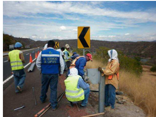
Fotografía No. 93. Vista durante el habilitado de separadores para la posterior colocación de defensa metálica.
