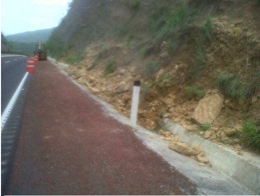
Fotografía No.80 Se observa que la malla de triple torsión ha cedido ante la acumulación de material.
