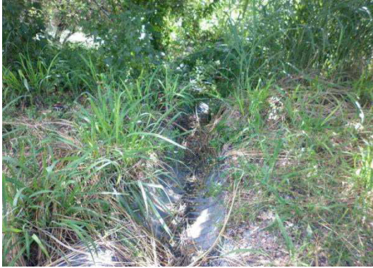
Fotografía No. 60 Se observa la condición que guardaba el lavadero
