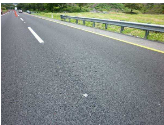
Fotografía No.83 Vista del tramo donde se observa que no existe vialeta blanca.
