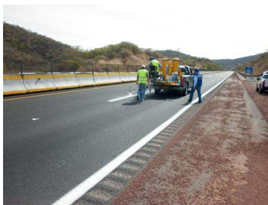
Fotografía No. 99. Se observa a la pintaría realizando el suministro y aplicación de pintura blanca en rayas discontinuas
