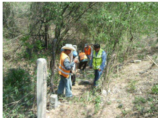
Fotografía No.14. Se observa a personal de la empresa contratista habilitando postes de concreto en el límite del derecho de vía.
