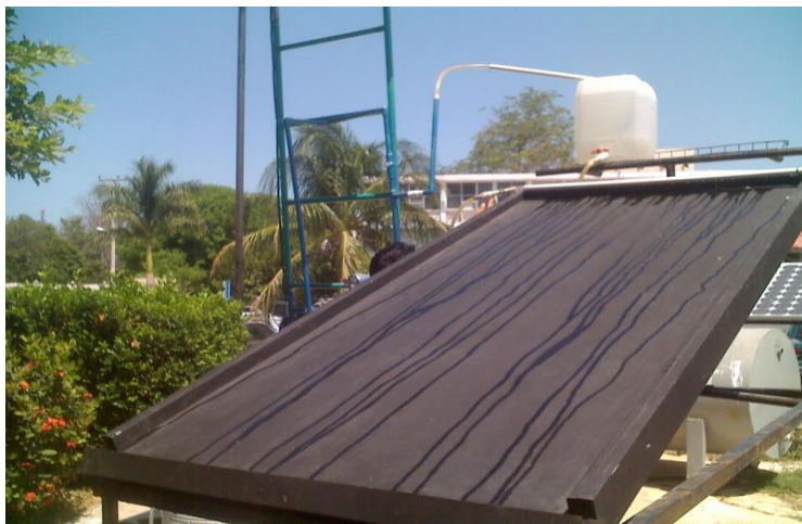
Fig. 4.13 Regenerador/ colector solar al inicio de operación
