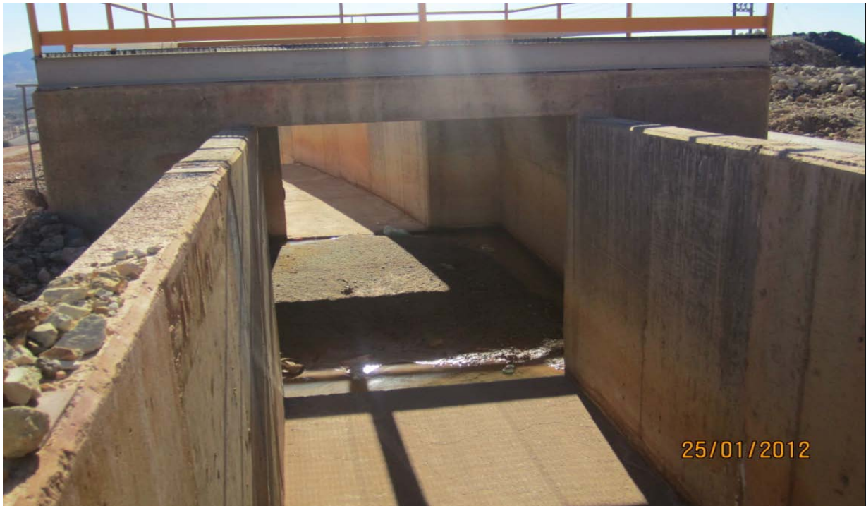
Imagen 11: Caja rompedora de velocidad CRV-1, Cadenamiento 00+ 520.
