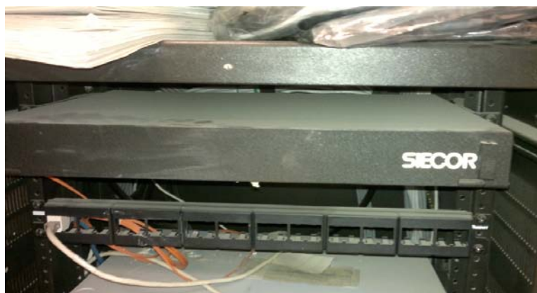
Fig. 3.33 Bastidor de fibra óptica con tapa.
