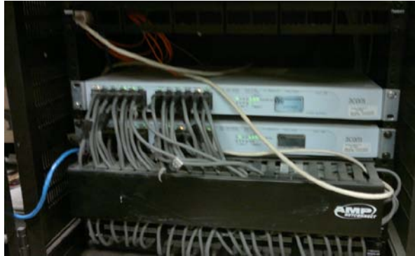
Fig. 3.28 Acometida de cableado estructurado
