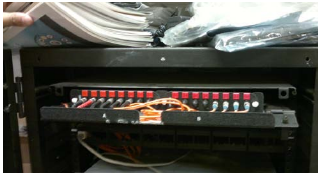
Fig. 3.29 Bastidor de fibra óptica
