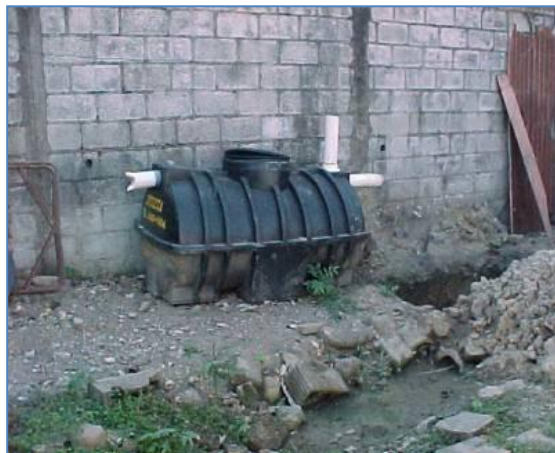
Fuente: Fotografía tomada en el Ejido la Mojonera, 2007 Figura 4.9 Fosa séptica
