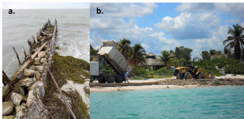
Figura 23. a. Deterioro de obras de protección costera y b. obras de restauración de playas.
