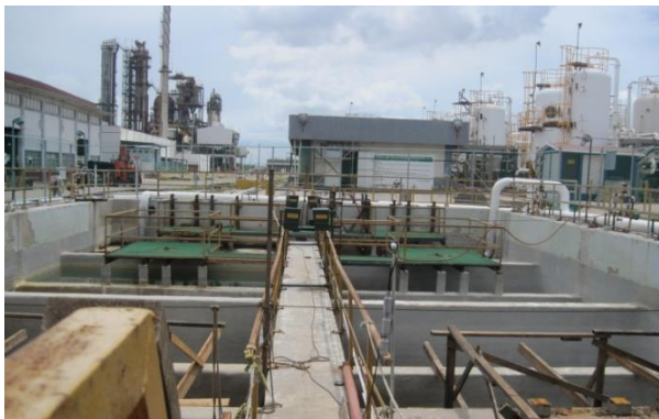
Figura 11. Vista general de la Fosa de Neutralización.
