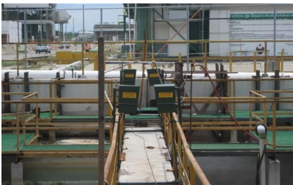
Figura 13. Pasillo principal de la Fosa de Neutralización.
