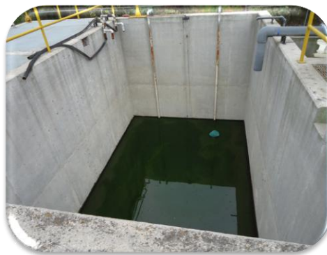
Tanque de igualación de caudales
