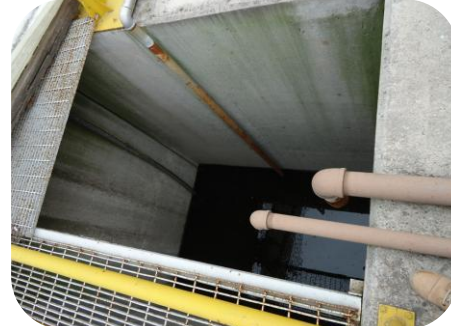
Digestor aerobio de lodos
