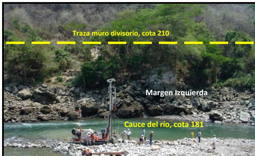
Fotografía 12. - Obsérvese el tamaño de los bloques de roca que habrá que remover para cimentar el muro divisorio.
