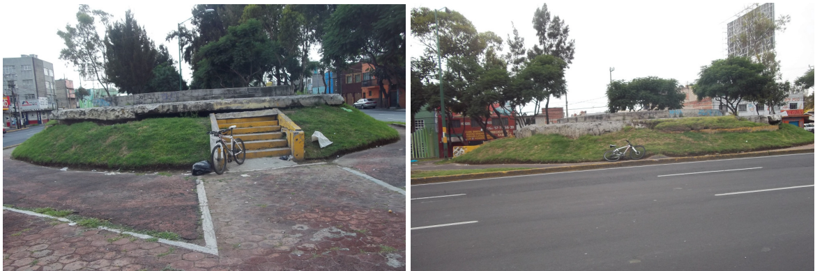
Figura B.1.34. Caso de emersión aparente ocasionada por el fenómeno de hundimiento regional en lumbreras construidas en la ciudad de México
