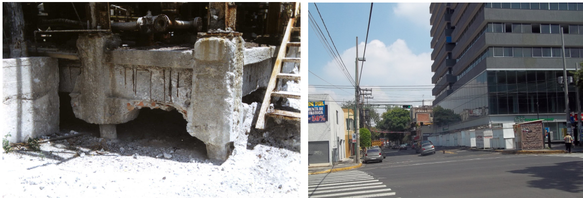
Figura B.1.55. Emersión aparente de estructuras cimentadas mediante pilotes
