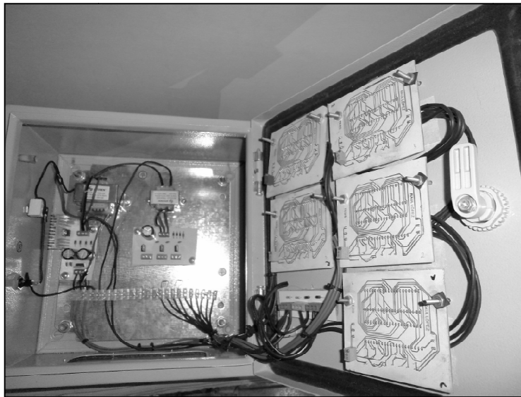
Figura 4.17 Interior del gabinete de control
