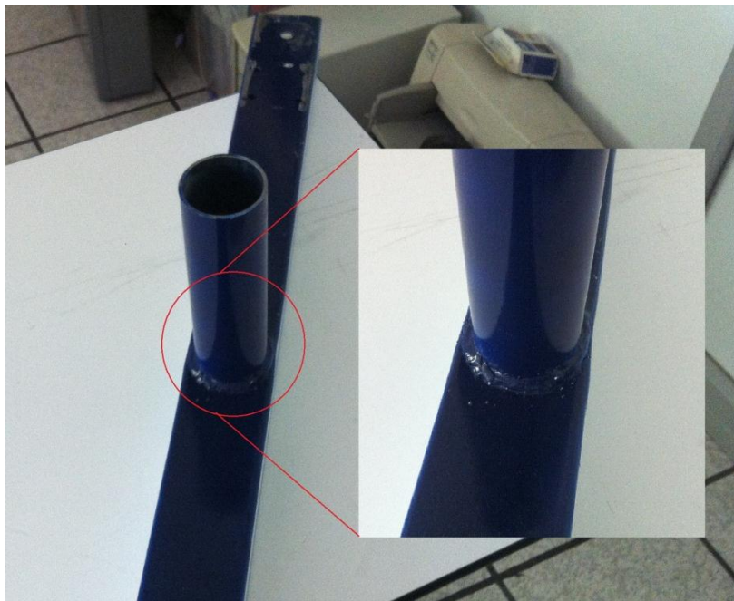
Figura 5.41 Deformación en la parte media del travesaño
