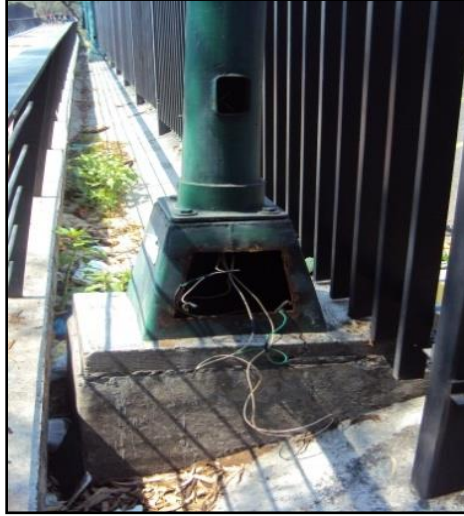
Figura 6. Luminaria descompuesta junto a Ciclovía
