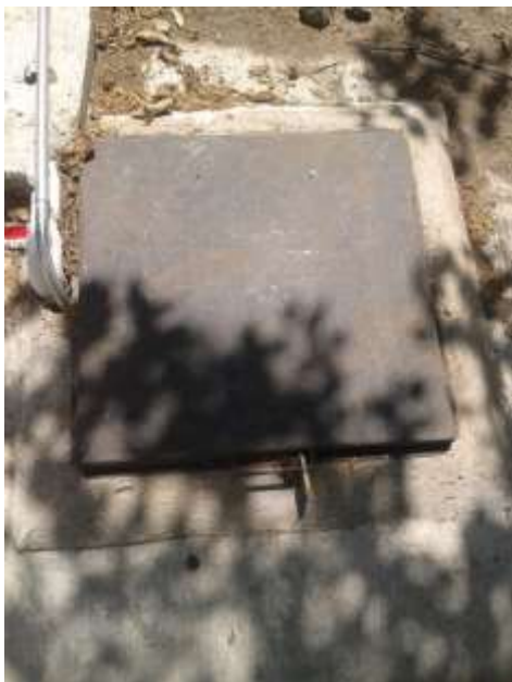
Figura 4-5. Cárcamo de bombeo
