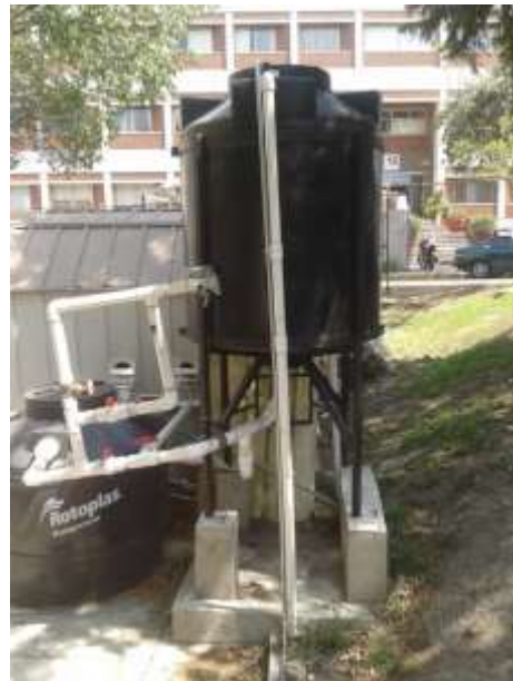
Figura 4-7. Tanque de igualación
