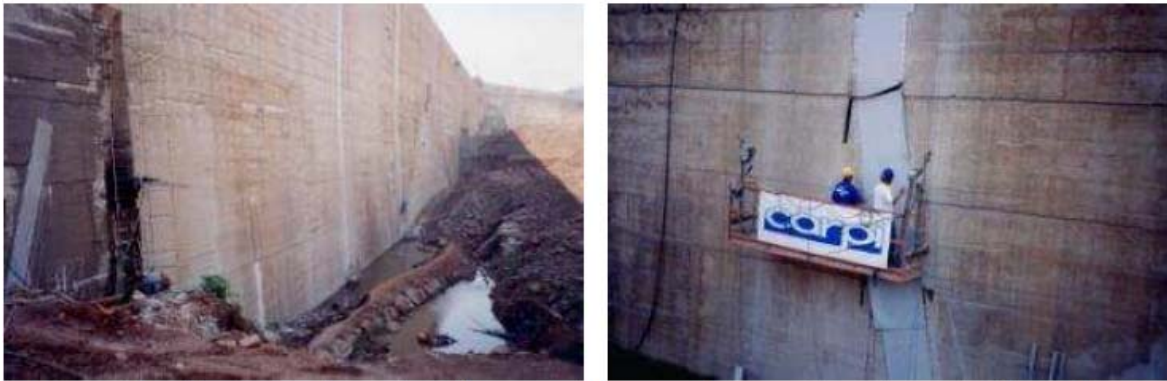
Figura VII-29 juntas de contracción en donde se presentaron grietas, aplicando un geocompuesto impermeabilizante.
