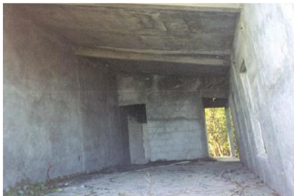
Figura 5.3. Falla por flexión del muro debido al giro de la cimentación en una estructura de mampostería confinada (H. Toledo; Huracán Pauline, Oaxaca, México, 1999).
