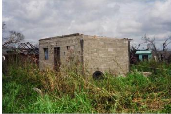
Figura 6.1. Daño en vivienda de mampostería confinada con material precario en techo.
