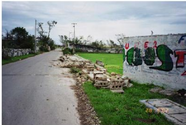
Figura 5.2. Daños y falla en muros de mampostería usados en bardas de colindancia, (H. Toledo; Huracán Pauline, Oaxaca, México, 1999).
