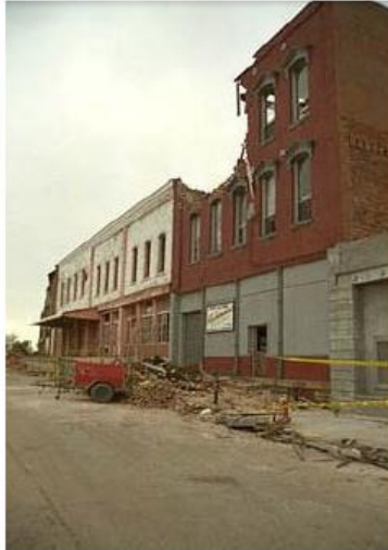
Figura 5.1. Daños en muros de mampostería por efecto de viento (Huracán Andrew, Florida, USA, 08/24/1992; Fotografía tomada de FEMA News Photo).
