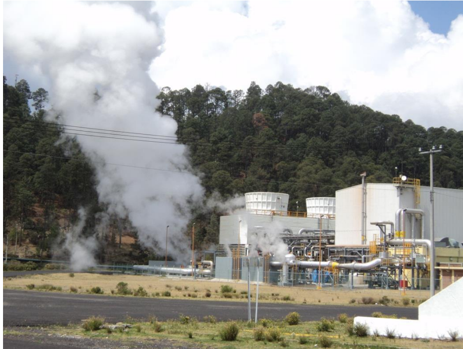
Figura 10. Central de generación geotérmica “Los Azufres” CFE
