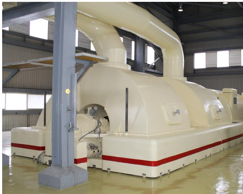
Figura 27.- Turbina (El autor)
