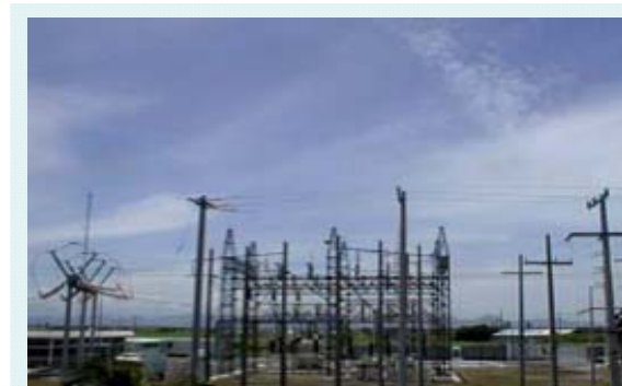
Subestación eléctrica CFE
