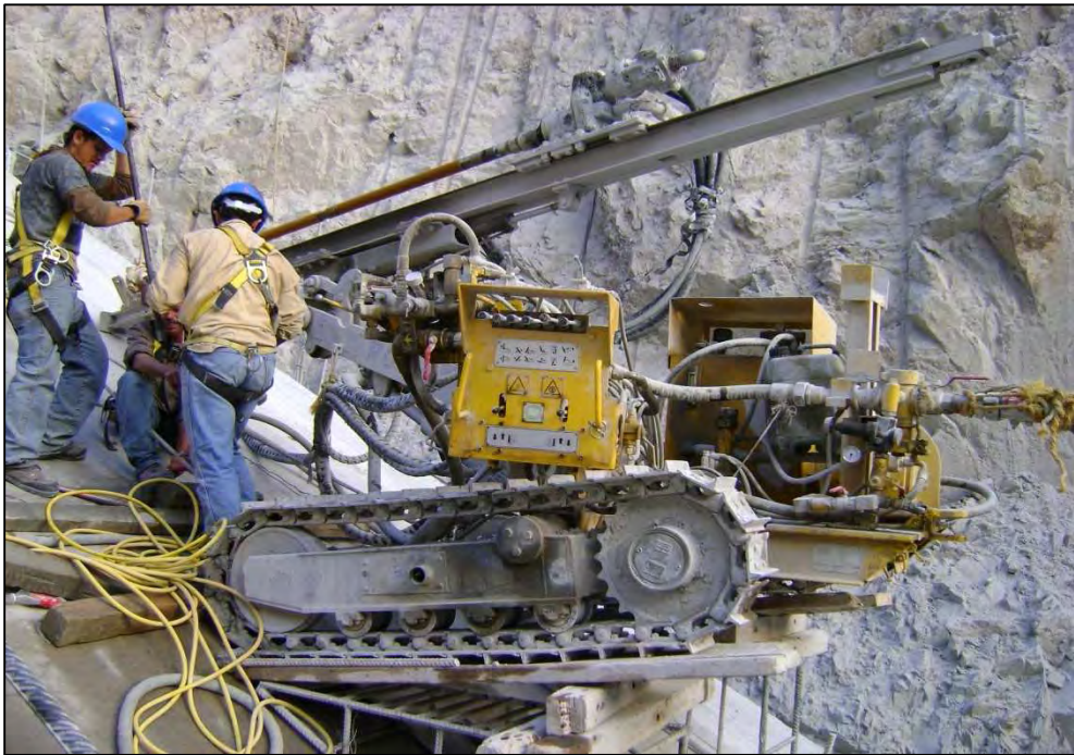
Fotografía 6.4. Equipo de perforación y plataforma utilizada para realizar los barrenos de inyección en el Plinto Margen Derecha.
