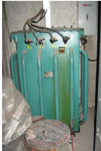
Foto 6.40 Transformador del Inst. Investigaciones Filológicas
