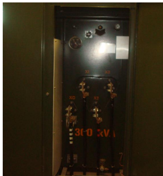
Foto 6.30 Transformador del Posgrado de Economía
