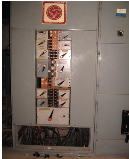
Foto 6.31 Tablero de Inst. Investigaciones Filosóficas
