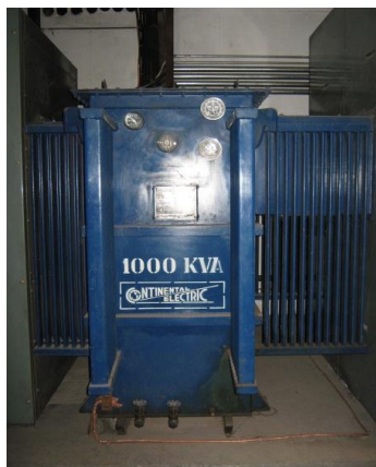
Foto 3.19 Transformador del UNIVERSUM
