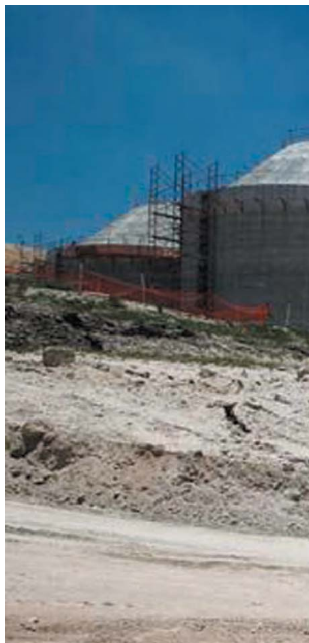
Figura 3.15 Planta de tratamiento de aguas residuales en Atotonilco
