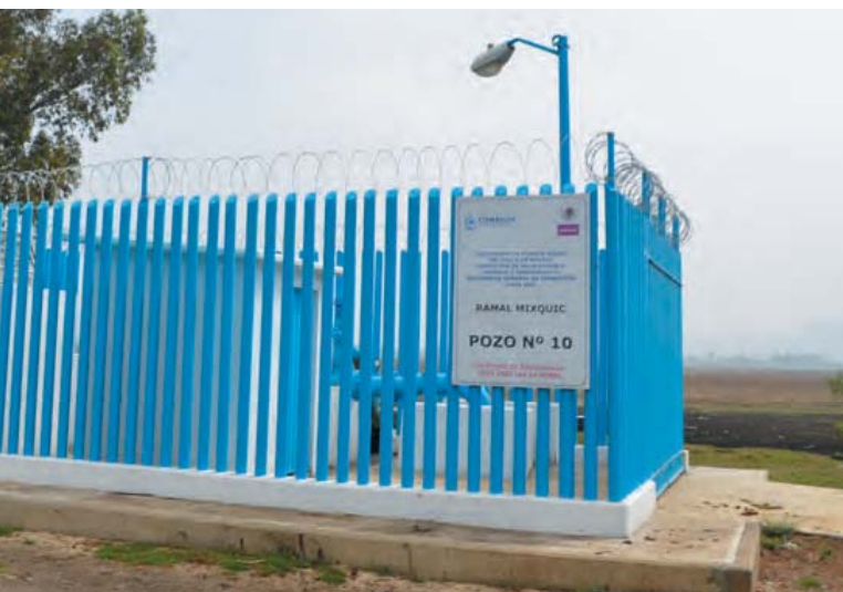
Figura 5.7 Batería de pozos Mixquic-Sta. Catarina
