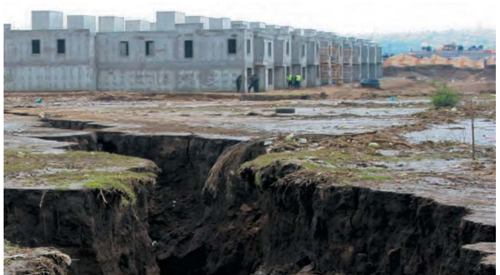
Figura 3.4 Grieta del suelo en Xico
