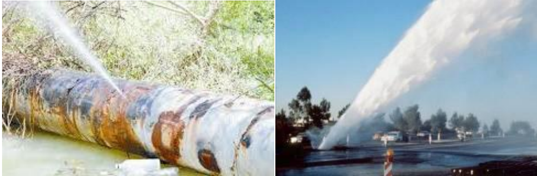
Figura 3.4 Fugas con alta presión en la tubería
