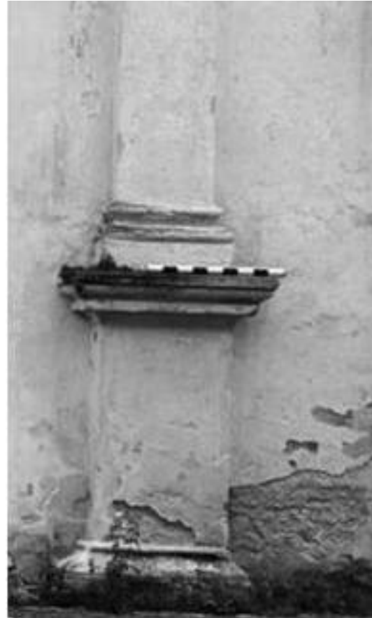
Ilustración 86 Proporción dupla en basamento de pilastras, iglesia de Belén, en este caso, Porres está explorando la escala apropiada para sus estructuras, obsérvese la escala gráfica, con pilastras de 1 vara de ancho, fotografía del autor, 2012
