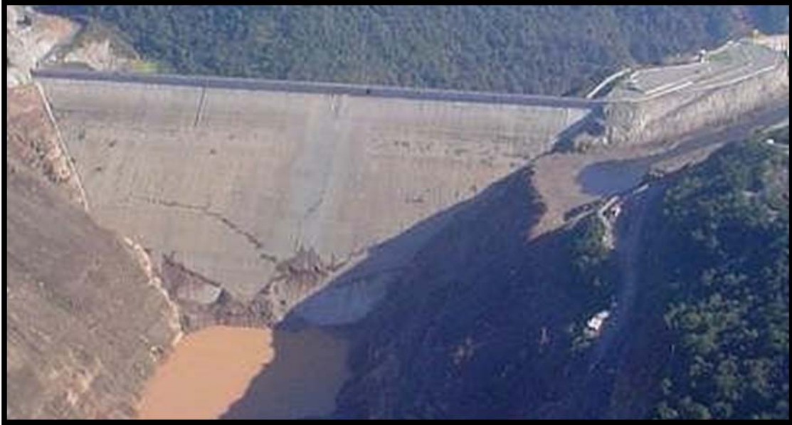
Figura 2.3. Vista aérea, junio del 2006, se muestran claramente grietas en la cara de concreto de la presa brasileña Campos Novos.
