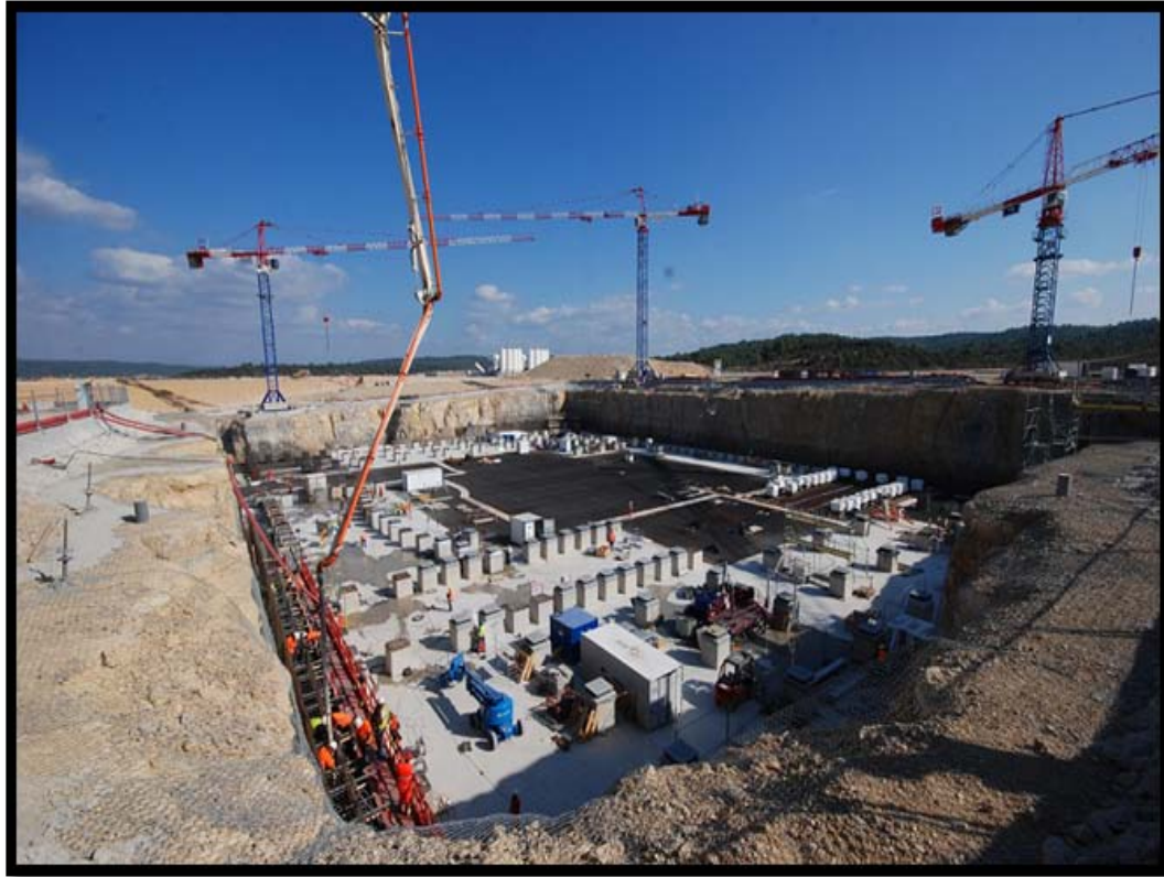
Figura 2.6. Proyecto ITER - Construcción de la cimentación que alojara el complejo del Tokamak, en Cadarache al Sudeste de Francia, septiembre del 2011.
