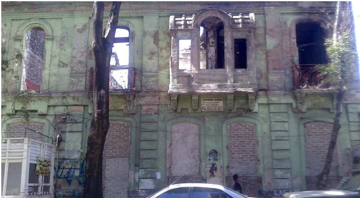
Predio abandonado, ubicado en la calle de Jaime Torres Bodet. Foto: Alejandro Avendaño Pérez, noviembre 2012.
