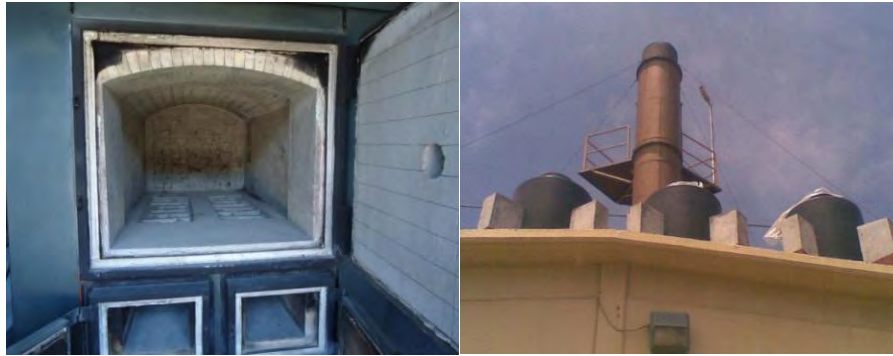
Figura 4.65 Cámara de ignición y chimenea
