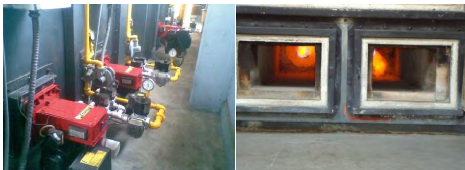
Figura 4.64 Sistema de quemadores
