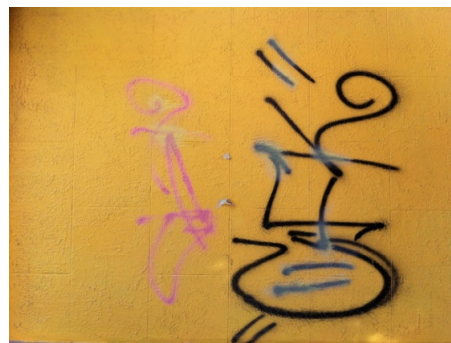
F6. Graffiti sobre la casa no. 103. Fotografía del autor, marzo del 2012.
