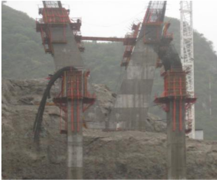
Figura 5.14. Daños ocasionados por el viento, armado de columnas totalmente doblado
