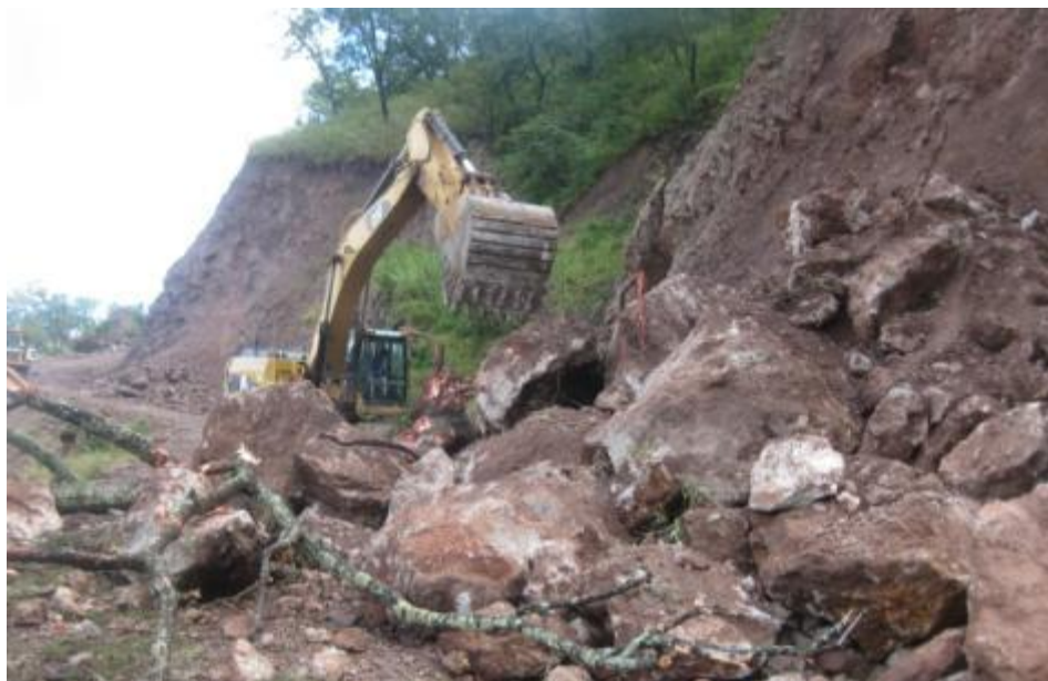
Figura 5.15. Deslave en los caminos de acceso al puente Baluarte ocasionado por las fuertes ráfagas de viento
