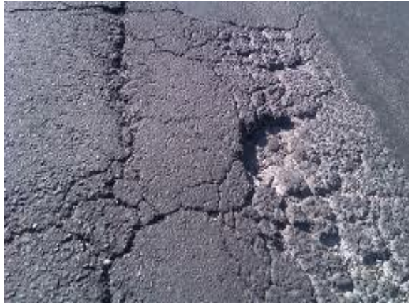
Figura 5. Ejemplo de un bache en una carpeta asfáltica (11)
