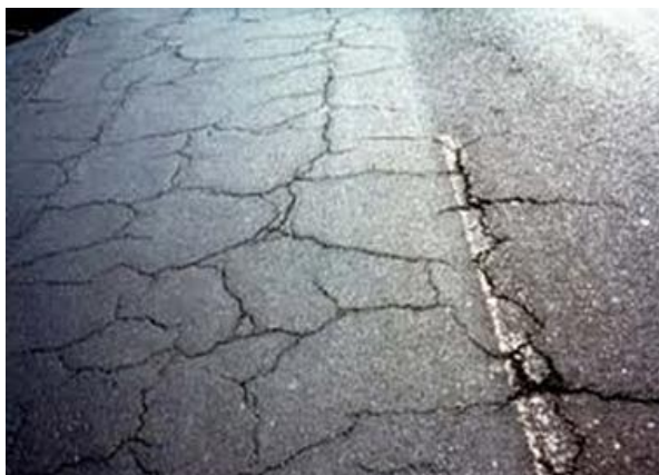
Figura 7. Ejemplo del agrietamiento en una carpeta asfáltica. (13)
