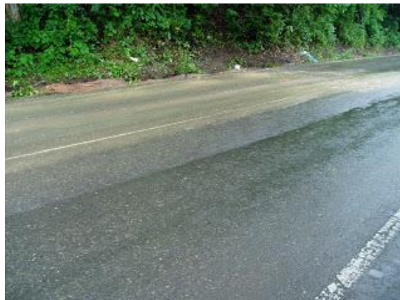
Figura 6. Ejemplo del ahuellamiento en una carpeta asfáltica (12)
