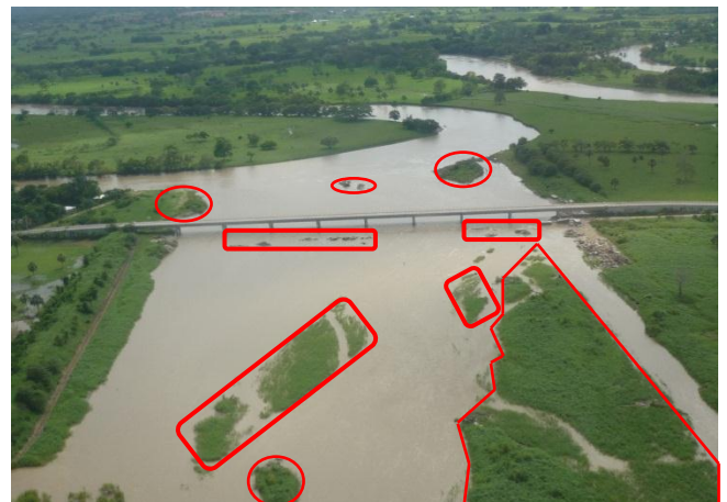
Figura 26. Condiciones del Cauce de Alivio en 2011. En rojo la presencia de azolve y material de construcción.
