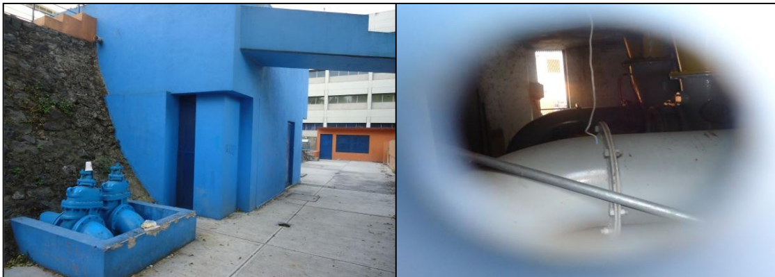
Figura 3.4 Equipo de bombeo
