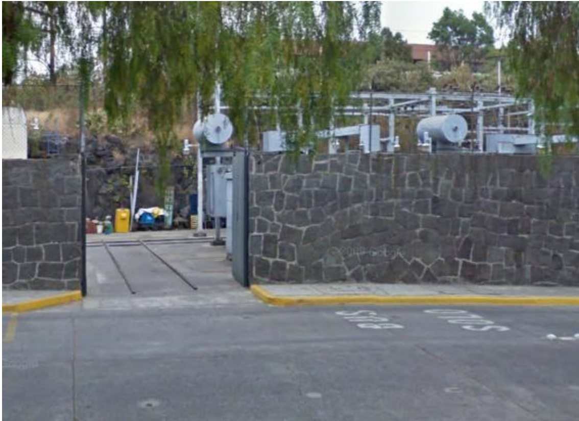
Fig. 1.9 Subestación General No. 1 en 6 [kV].
