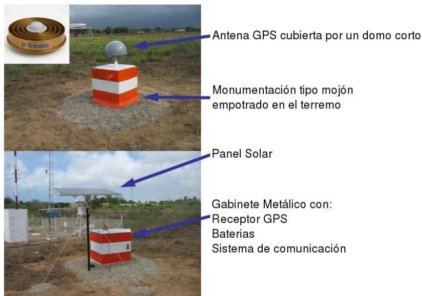
Figura 4.2: Monumentación tipo mojón. Superior: Mojón, antena GPS cubierta por un domo corto (radome) como cubierta protectora. Superior izq: vista en planta de antena GPS tipo Choke Ring de Trimble. Inferior: Panel Solar y Gabinete Metálico que contiene el receptor, las baterías e instrumentación necesaria para la comunicación y transmisión de datos. Modificada de Monumentación de estaciones , página web del proyecto GEORED http://geored.ingeminas.gov.co/index.php/es/inves/redgps/monumentacion-de-estaciones
