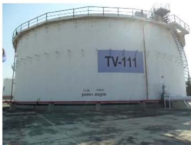
Figura 4. Tanque de Almacenamiento en Refinería
