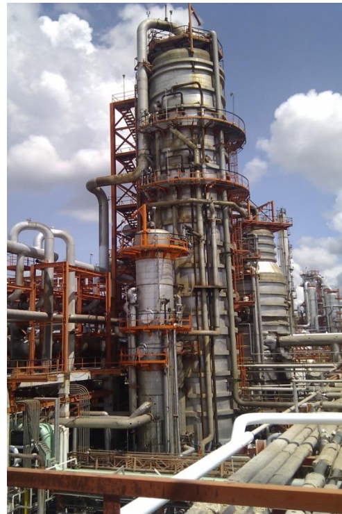
Figura 3. Torre de fraccionamiento
