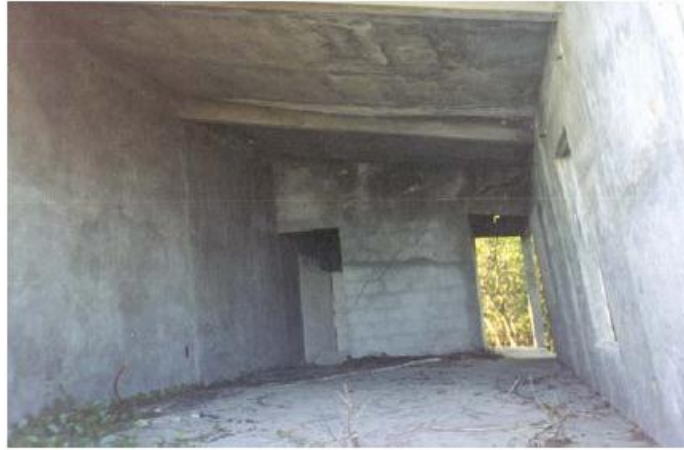
Figura 3.15 Falla por flexión del muro debido al giro de la cimentación en una estructura de mampostería confinada 16
