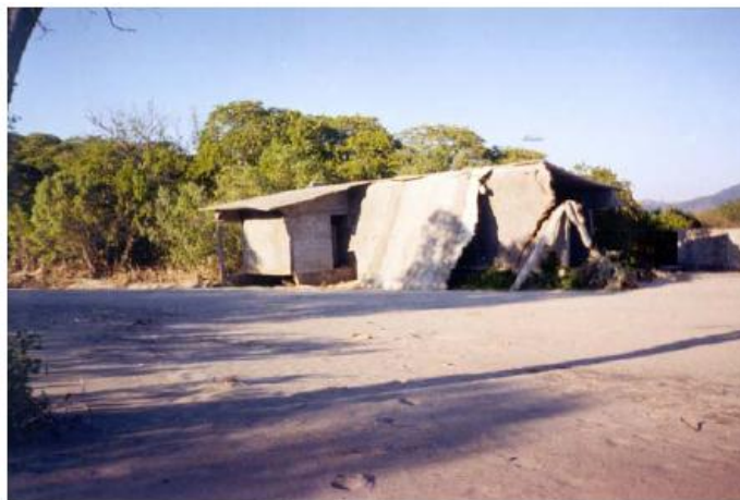
Figura 3.14 Falla de una estructura de mampostería confinada por efecto del viento en las costas del estado de Oaxaca 15
