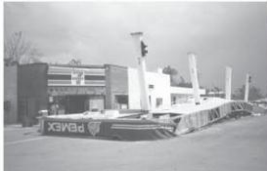
Figura 3.6 Daños estructurales por viento
