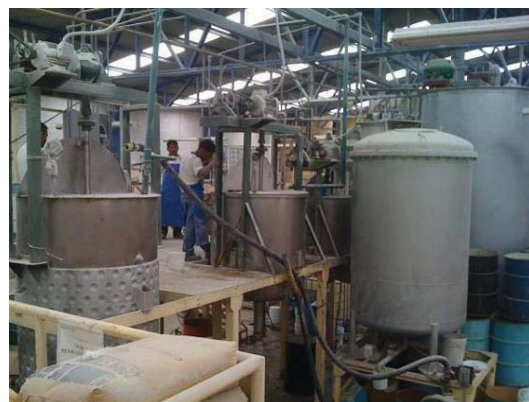
Figura 1.3. Área de mezcladoras y reactores
