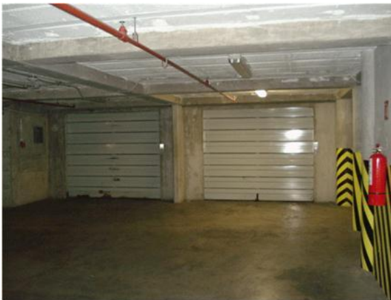
MONTACARGA DE AUTOMOVILES EN SÓTANO
