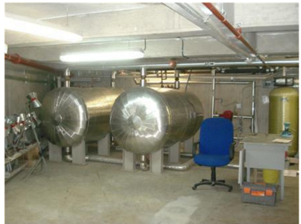
TANQUES DE AGUA CALIENTE EN SÓTANO
