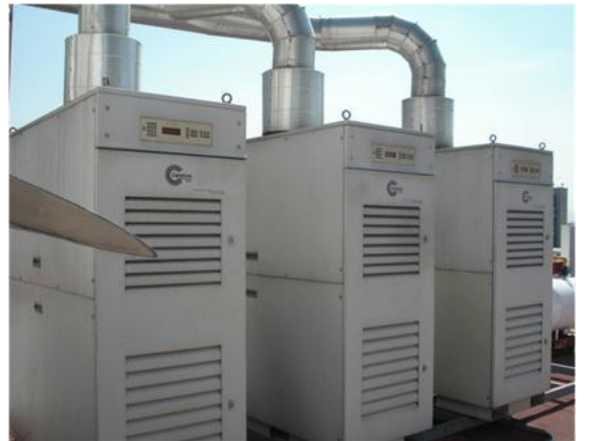
BATERIA DE MINITURBINAS GENERADORAS EN AZOTEA.
