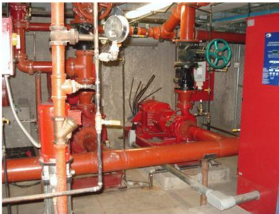
EQUIPO CONTRA INCENDIO EN SÓTANO
