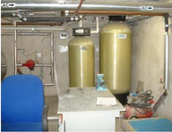
TRATADORA DE AGUA EN SÓTANO
