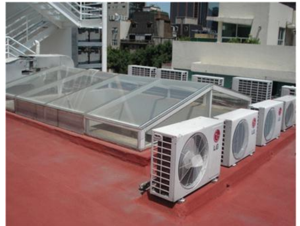
CONDENSADORES DE AIRE ACONDICIONADO GIMNASIO
