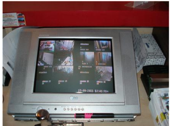
MONITOR DE CCTV EN RECEPCION
