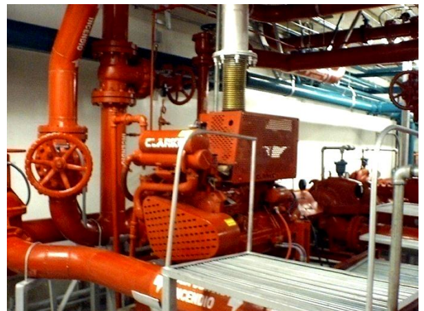
Motobomba de combustión interna
