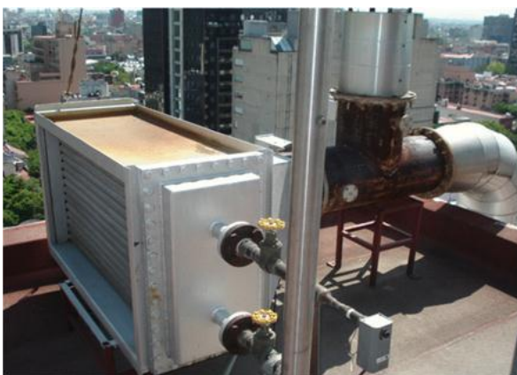
INTERCAMBIADOR DE CALOR EN AZOTEA CTO. MAQUINAS
