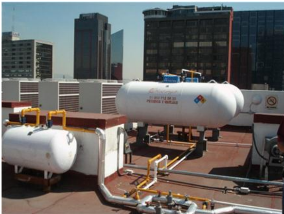
TANQUES ESTACIONARIOS DE GAS PARA MINITURBINAS
