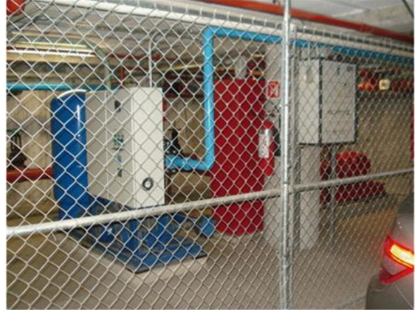
HIDRONEUMÁTICO EN SÓTANO
