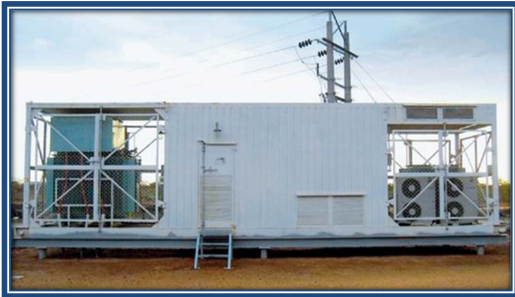
Figura II.19 Variador de Frecuencia.
