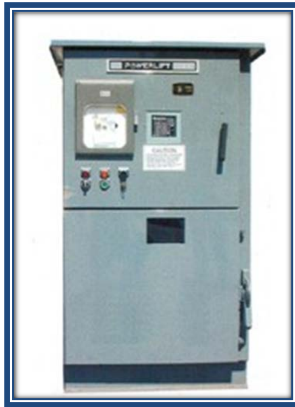
Figura II.16 Tablero de Control.
